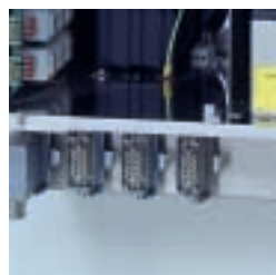
Разъемы в шкафу управления
